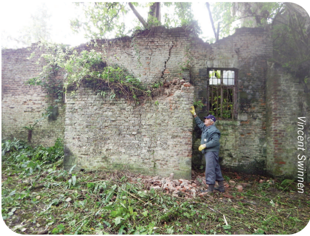
Eugénie et Paula : cage d'escalier qui s'est effondrée et dont on va reconstruire le mur
