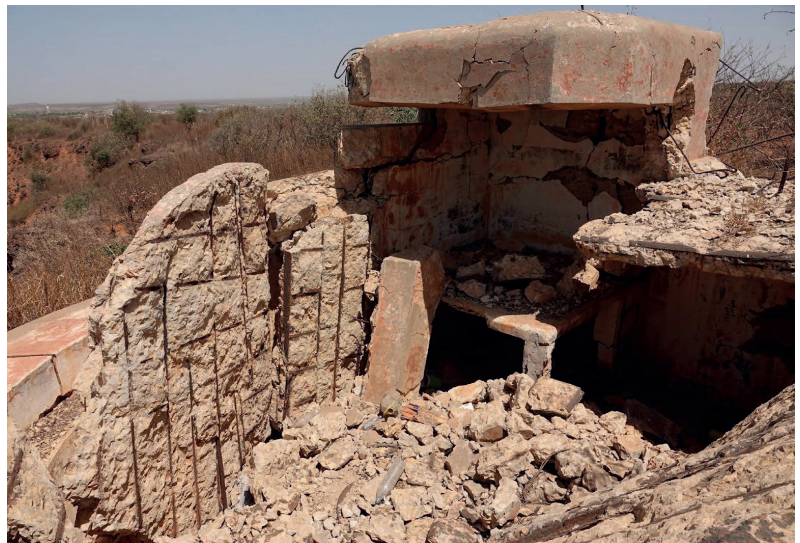
Le poste directeur de tir avec sa dalle de ciel effondrée.
